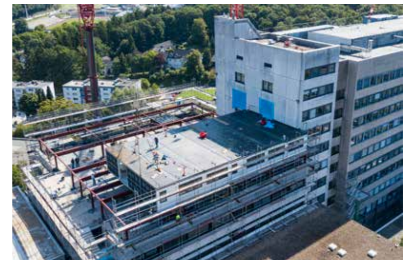
Surélévation sans interruption des activités de la clinique grâce à la construction modulaire propre et silencieuse
